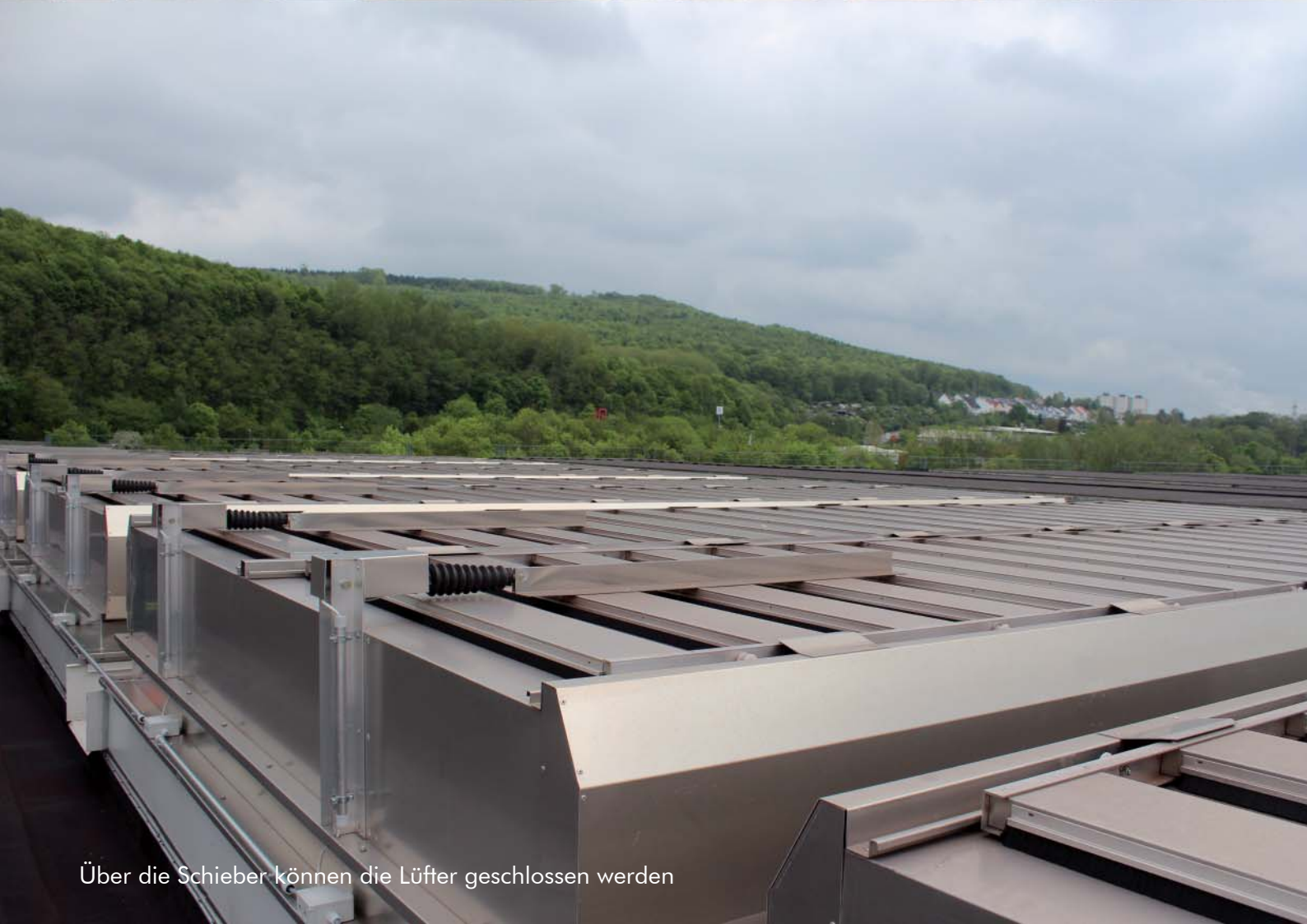
In die Labyrinthlüfter eingesetzte Kulissenschalldämpfer sollen eine Lärmbelastung verhindern
