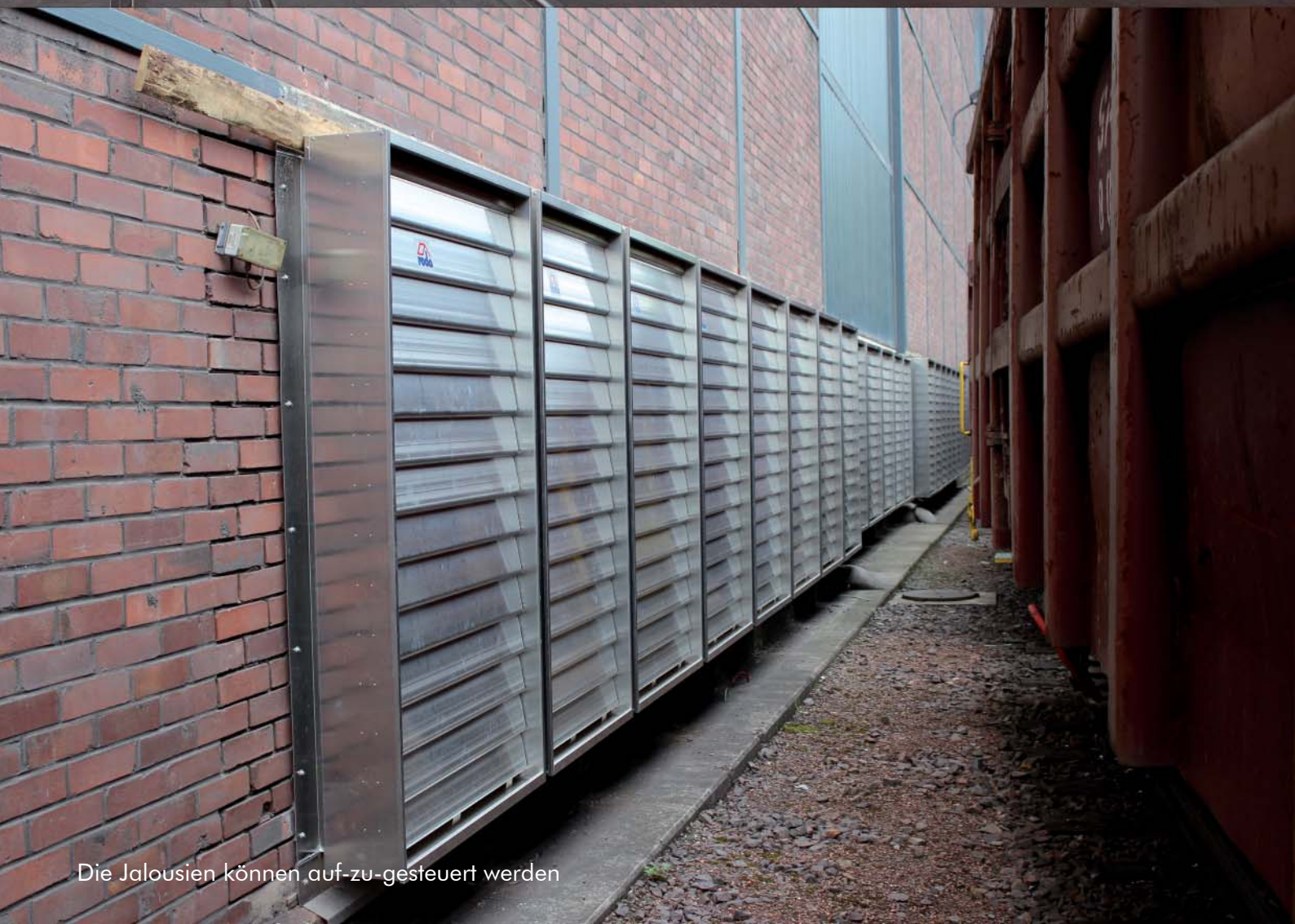
Zuluftjalousien entlang der Kühlstecke
